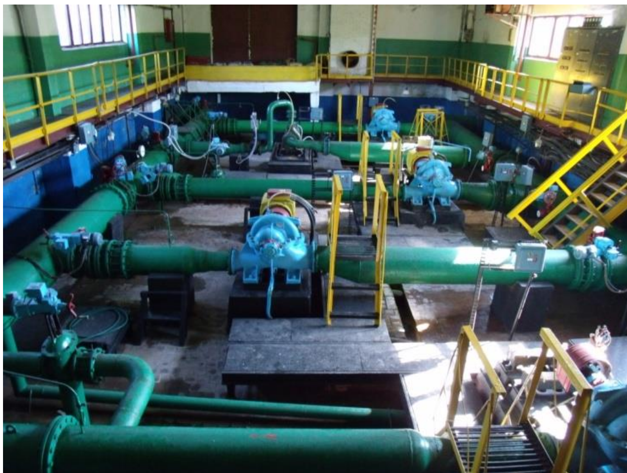
Система водопостачання. Насосне обладнання ВНС 4-го підйому.
